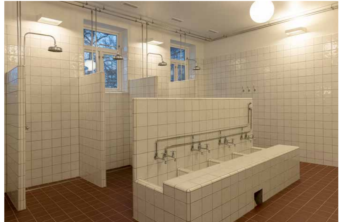
DUSJROMMET FOR HERRER er tilbakeført. Fotbad og dusjbåser er basert på skjemaer og detaljer av innredningen funnet på Byarkivet. Noen detaljer er tilpasser dagens hygienekrav/tilgjengelighetskrav og dagens tilgang på originale materialer og utførelse. Rommet er ikke fredet.
