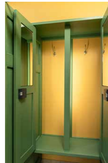
HERREGARDEROBEN ER FREDET og tilbakeført til original utførelse. Garderobebåser er restaurert og overlys tilbakeført. I enden av rommet sees ny trappeforbindelse til ny guttegarderobe/skolegarderobe i underetasjen
